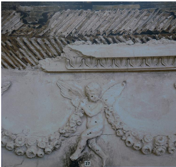
Over englen er stukken ødelagt og er faldet ned.
